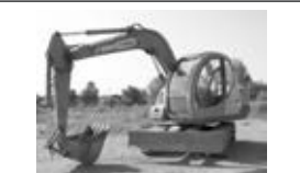
Качественные работы экскаватором 7 тонн, ковш 0,35 куб. м, отвал. Бульдозер-планировщик. Автокран «КАТО» 20 т, 24 м. Т.: 8-924-642-21-72, 8-914-015-07-77. (52/36).
