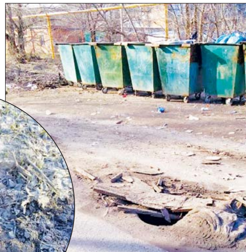
Из-за канализации асфальт на проезжей части просел, и образовалась яма. Недалеко от школы № 1 — два открытых люка.
