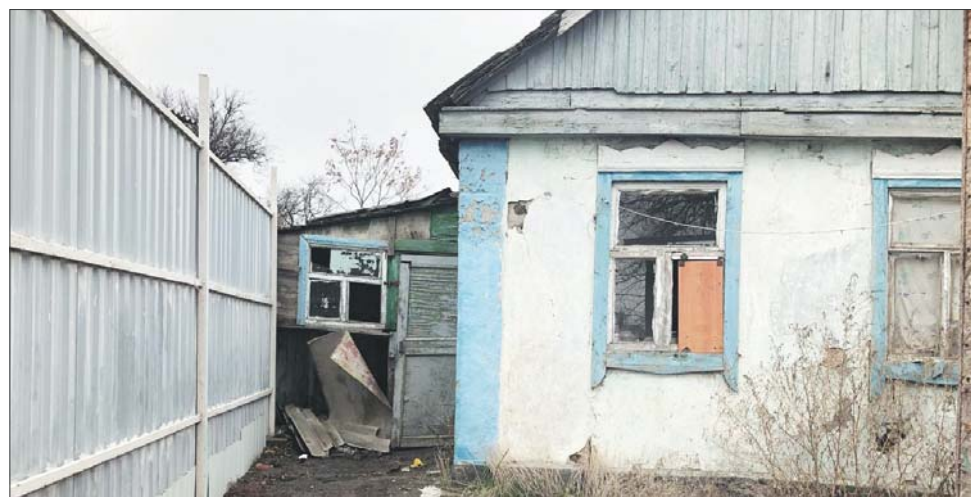
Всё, что можно приобрести на «материнский капитал» — разрушенный однокомнатный домик без коммуникаций.
