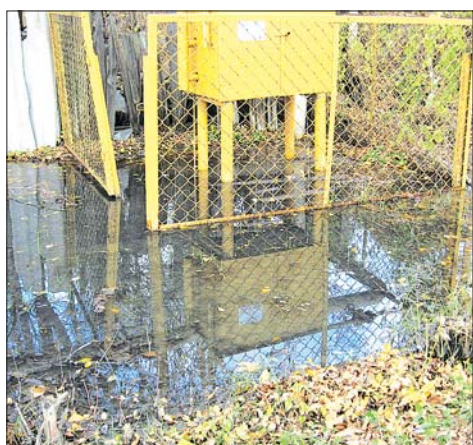
Газовая подстанция оказалась в воде.
