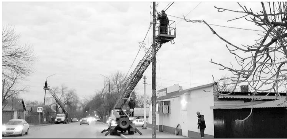
Шахтинцы неделю жили без электричества и отопления.
