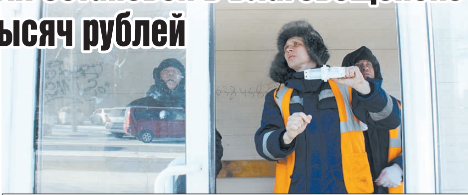
Ремонтировать теплые павильоны специалистам ГСТК приходится каждую неделю.
