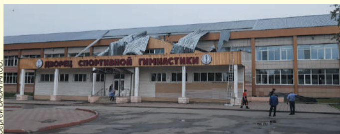
Кровля спортивного сооружения не выдержала натиска ветра.
