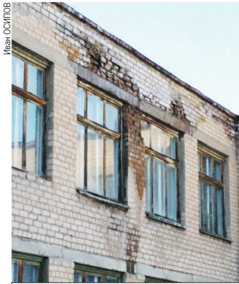
Здание не видело капремонта 41 год.
