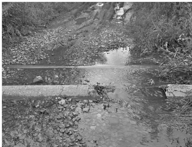
Вода смыла щебенку на дамбе.
