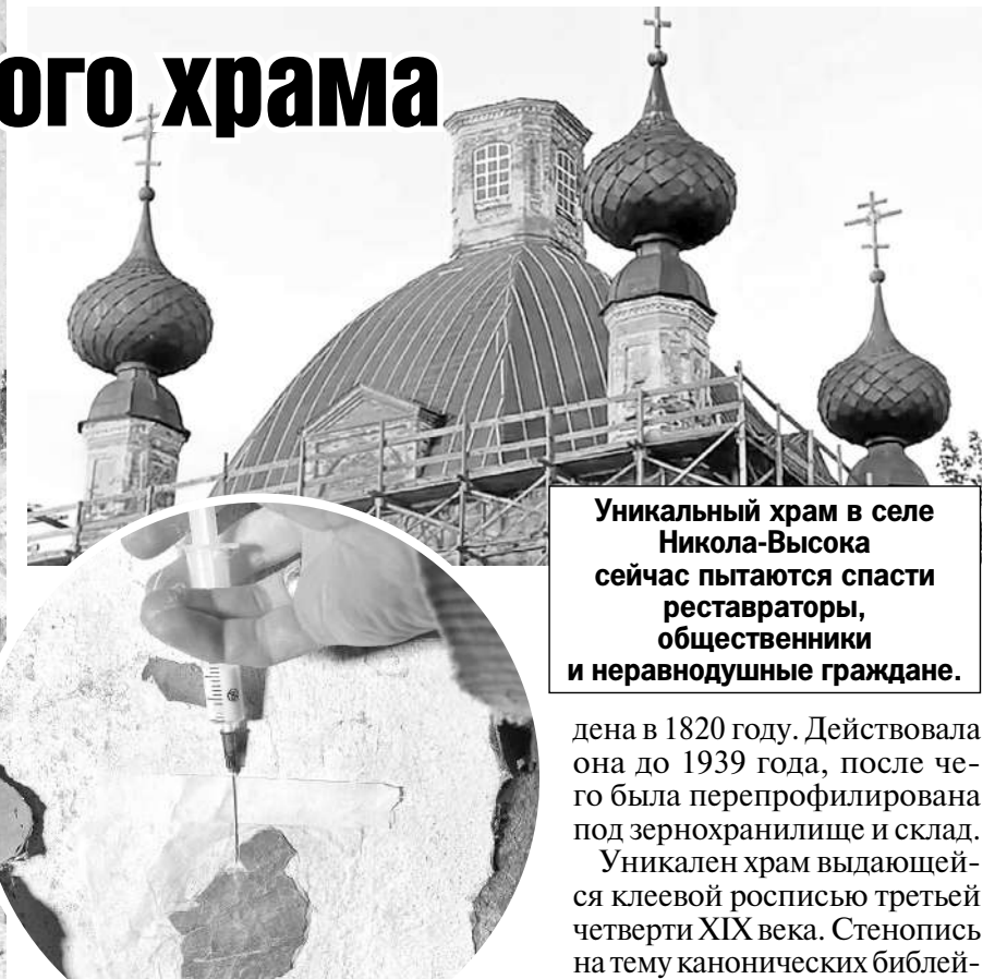
Реставраторы уже провели подготовительные работы на некоторых росписях и укрепили красочный слой.
