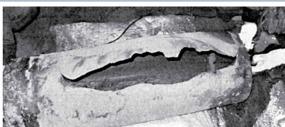
Та самая дыра в трубе, из которой вытекала нефть.
