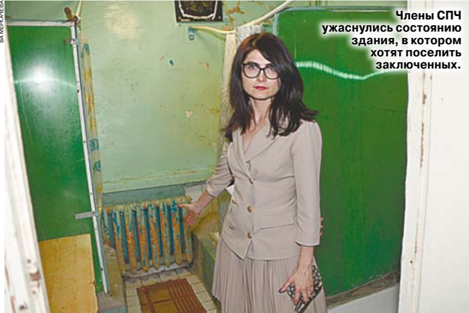
Члены СПЧ ужаснулись состоянию здания, в котором хотят поселить заключенных.
