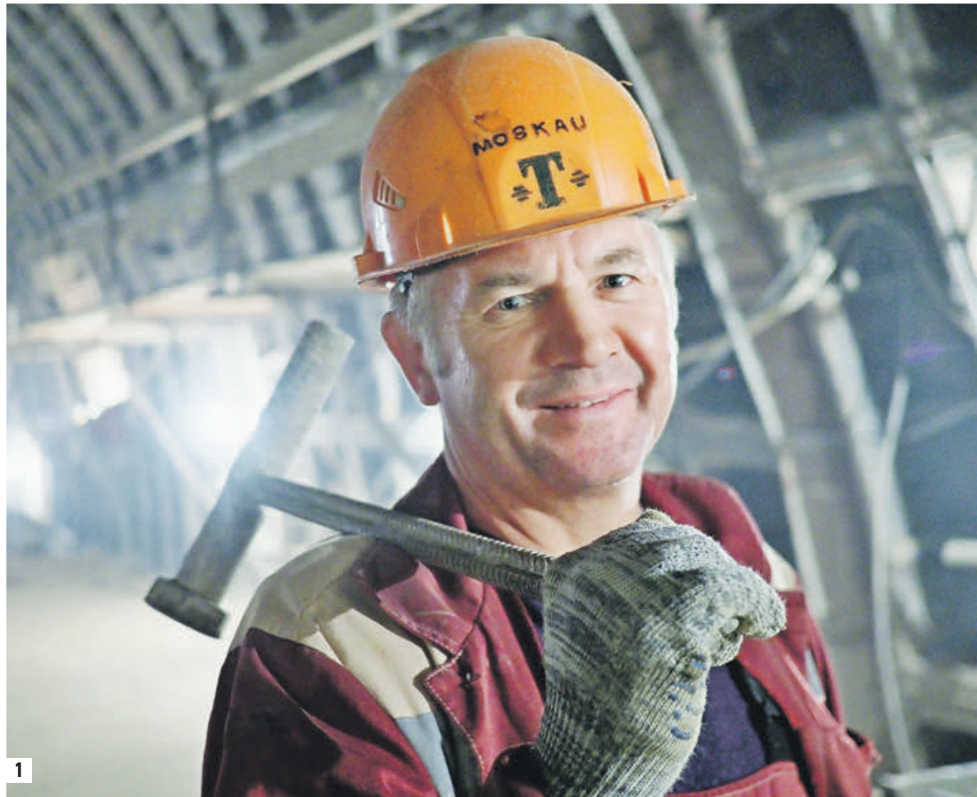
1 Вчера 10:49 Слесарь-монтажник Николай Тимонин занят на строительстве станции «Савеловская» Большой кольцевой линии метрополитена (1) Проект визуализации дизайна станции «Савеловская». Архитекторы предложили стилизовать станцию под тоннель метро. Своды и стены будут прикрыты прозрачными панелями (2)
