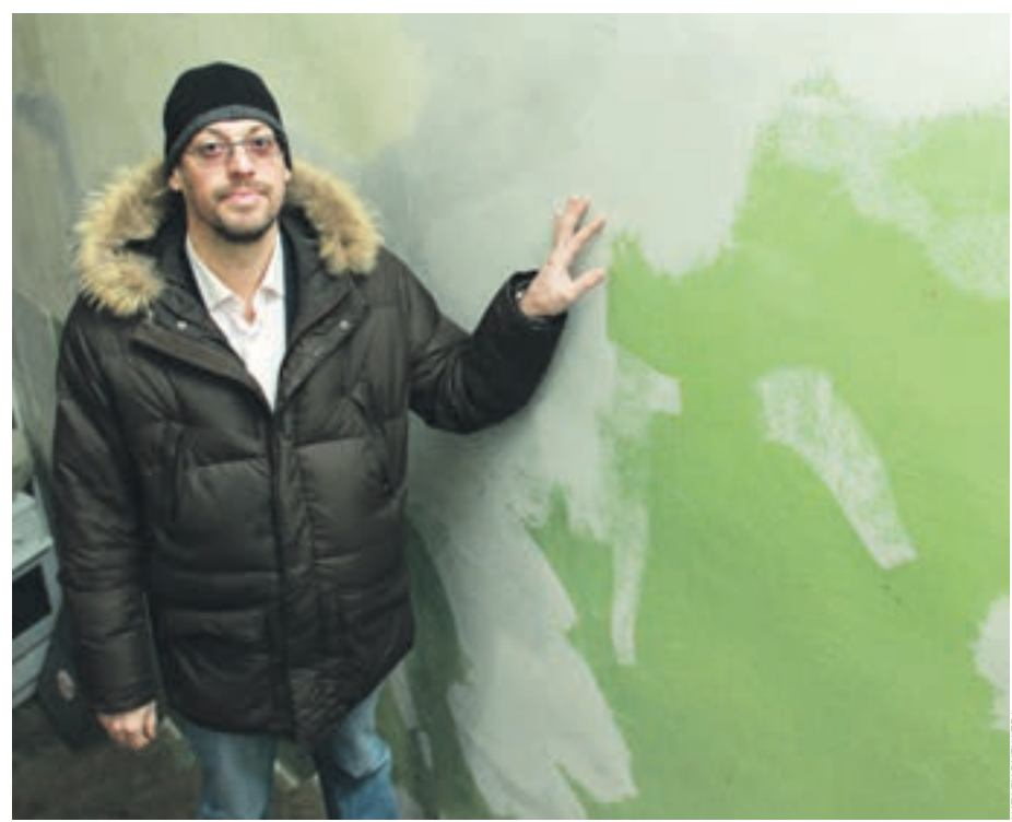
Вчера 11:13 Заместитель главы управы Басманного района Вячеслав Иванков показывает состояние стен подъезда № 2 дома № 40, строение 1, по улице Покровке
