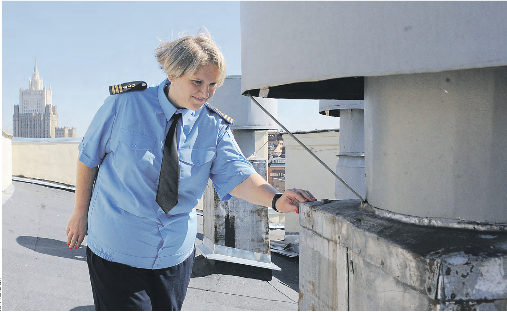
Вчера 11:04 Заместитель начальника жилищной инспекции по Центральному округу Дарья Латышева проводит осмотр кровли жилого дома на Ростовской набережной в рамках проверки готовности к осенне-зимнему периоду
