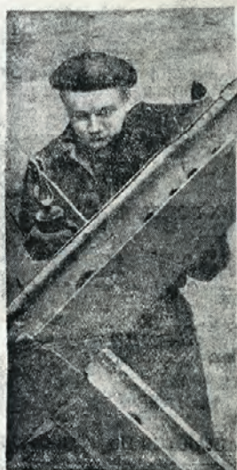
В эти дни все подчинено интересам фронта — защите Москвы. На снимке сварщик ставящий одного из трамвайных депо Москвы П. П. Первушин за сваркой стальных надолб, преграждающих продвижение фашистским танкам. Фото В. ИГНАТЬЕВ
