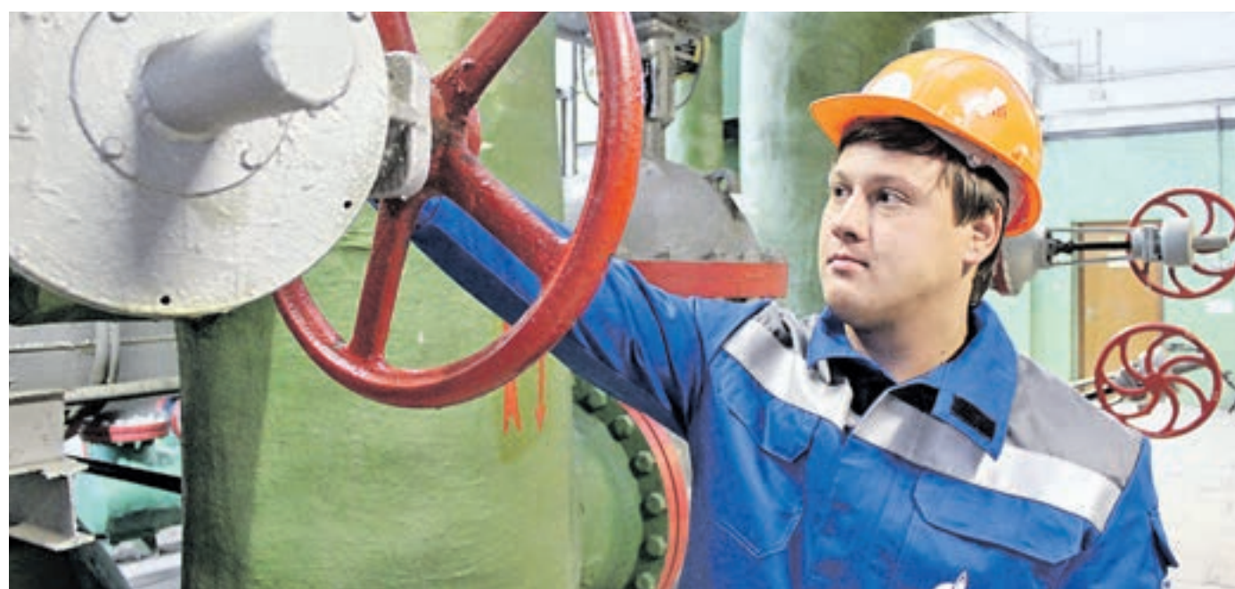
7 июля 2016 года. Старший мастер филиала ПАО «МОЭК» проводит проверку оборудования. Главная задача «МОЭК» — бесперебойное и надежное обеспечение Москвы отоплением и горячим водоснабжением
