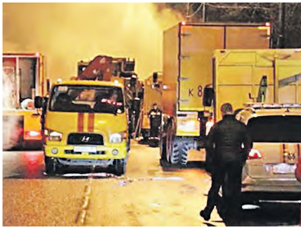
► 29 ноября 2017 года. Прорыв трубы на пересечении Байкальской и Иркутской улиц
