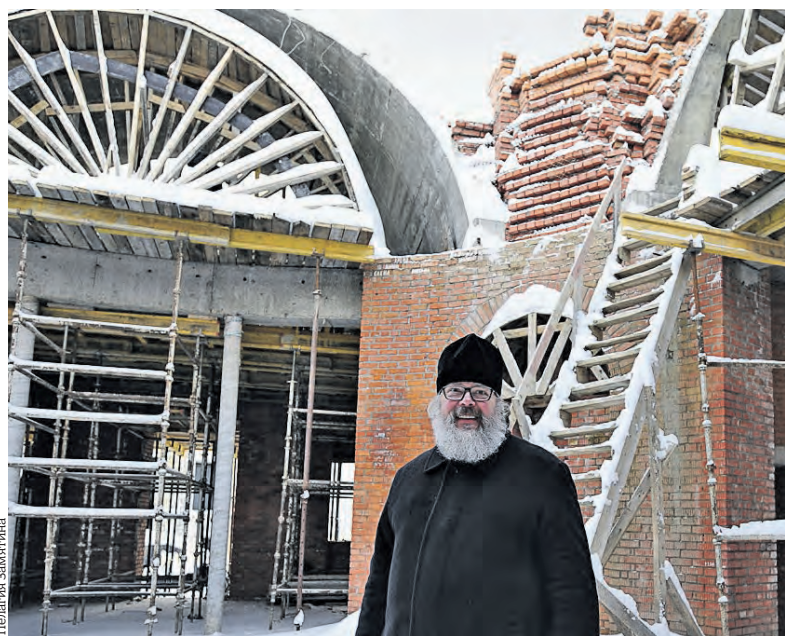
1 февраля 2018 года. Настоятель храма Живоначальной Троицы в Чертанове отец Константин Сопельников на месте его строительства
